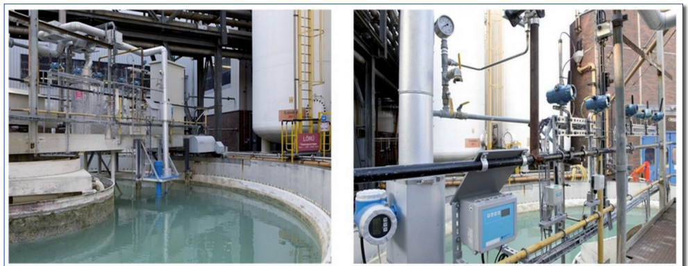
Les deux premiers tests chez BASF ont pris place dans une station d'épuration et une installation de traitement d'eau.
