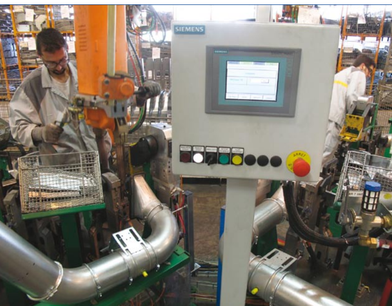
Pupitre de conduite décentralisé DLOP, en lien avec un LOP.
