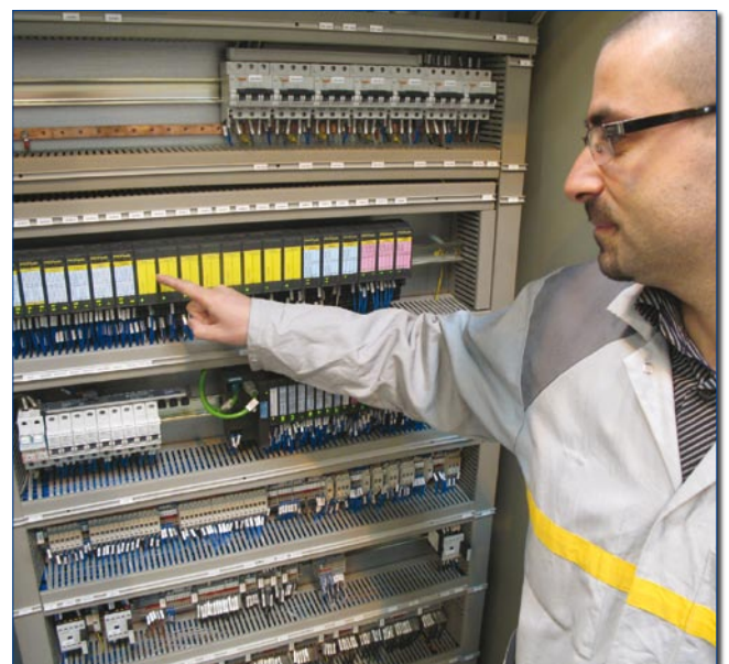
Avec le projet Scube, Profisafe et les automates de sécurité Simatic font leur entrée chez Renault.
