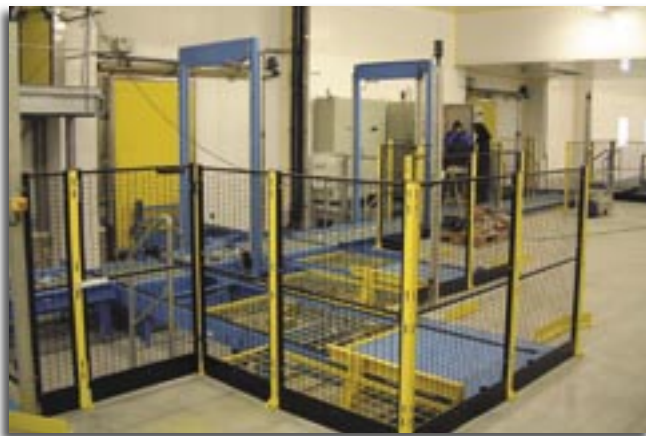
Poste de réception avec dispositif de contrôle gabarit.
