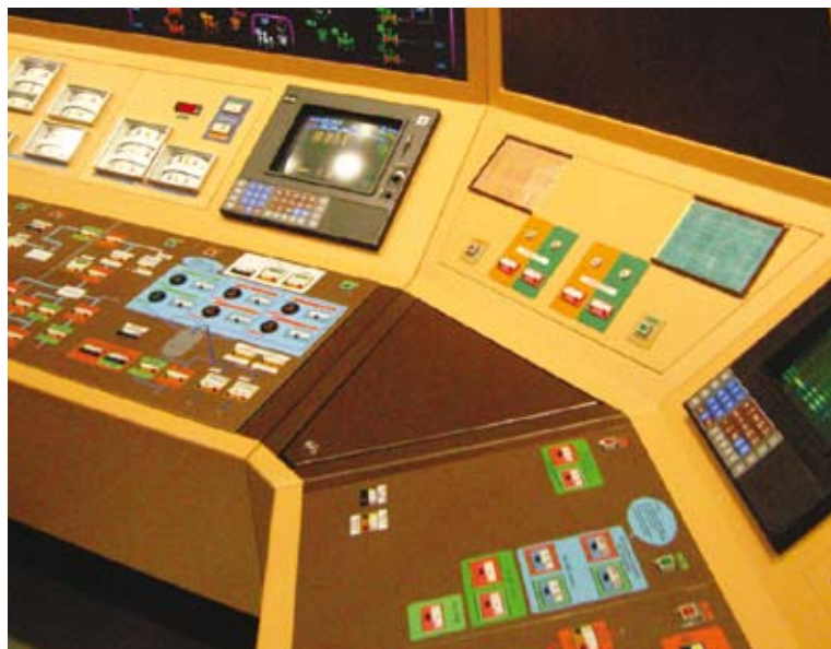
Les équipements de reprise en manuel de l'installation en cas de défaillance de l'informatique.
