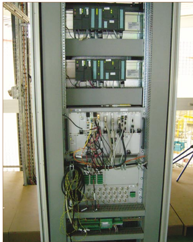
Armoire de commande avec les automates programmables.
